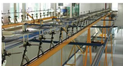
悬挂链生产线
